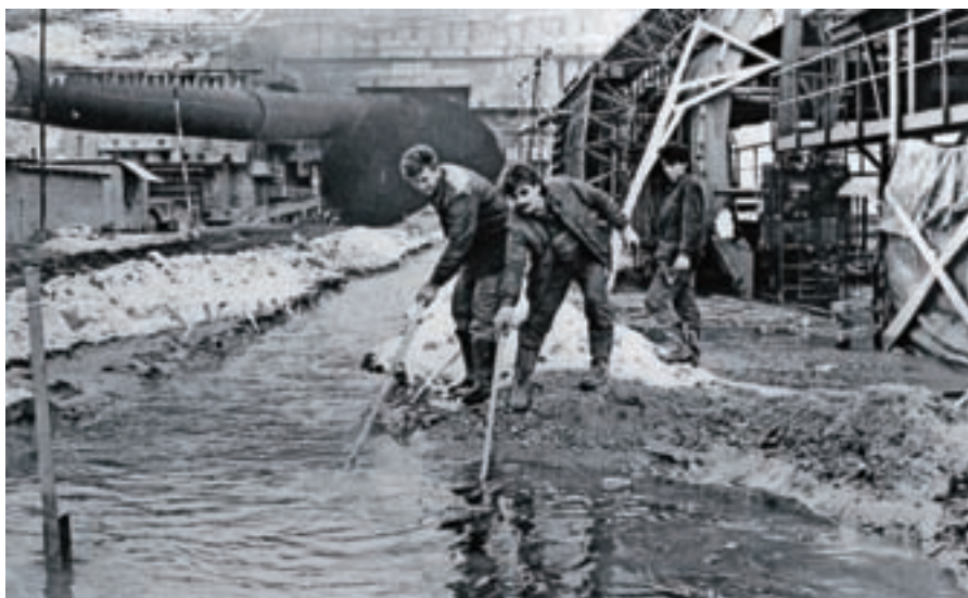
Močan izvir vode ovira gradnjo Karavanškega predora, 1989. / Foto: Franc Perdan, GG, hrani Gorenjski muzej
